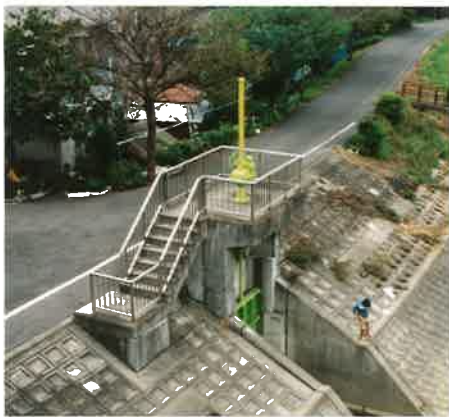
増水で逆流したと見られる水門
