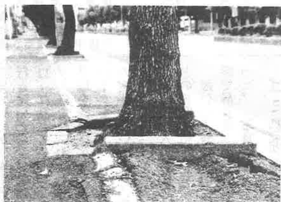
長年のうちに波打った歩道の境界ブロック
